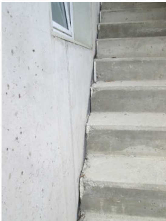
Bild 23: die talauswärtige Außentreppe löst sich von der Garagenwand (ca. 1cm)
