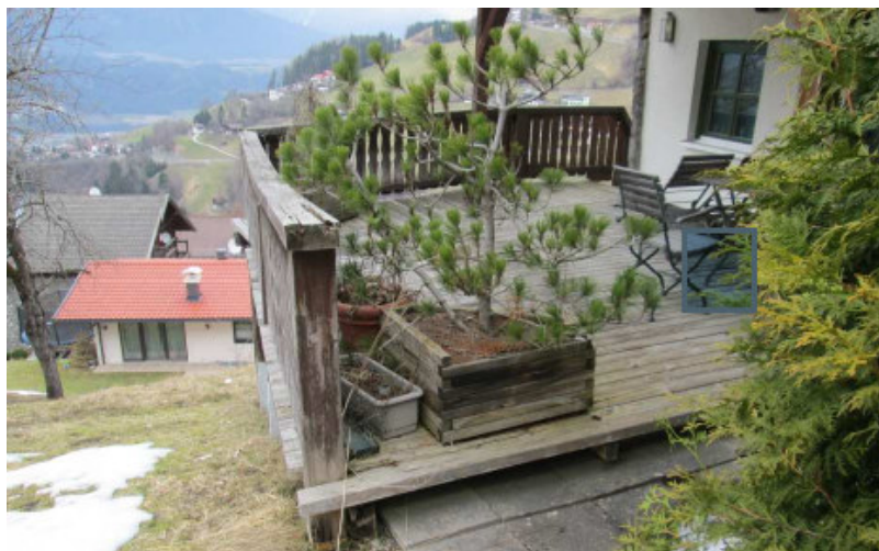
Bild 25: stark hängende Holzterrasse
