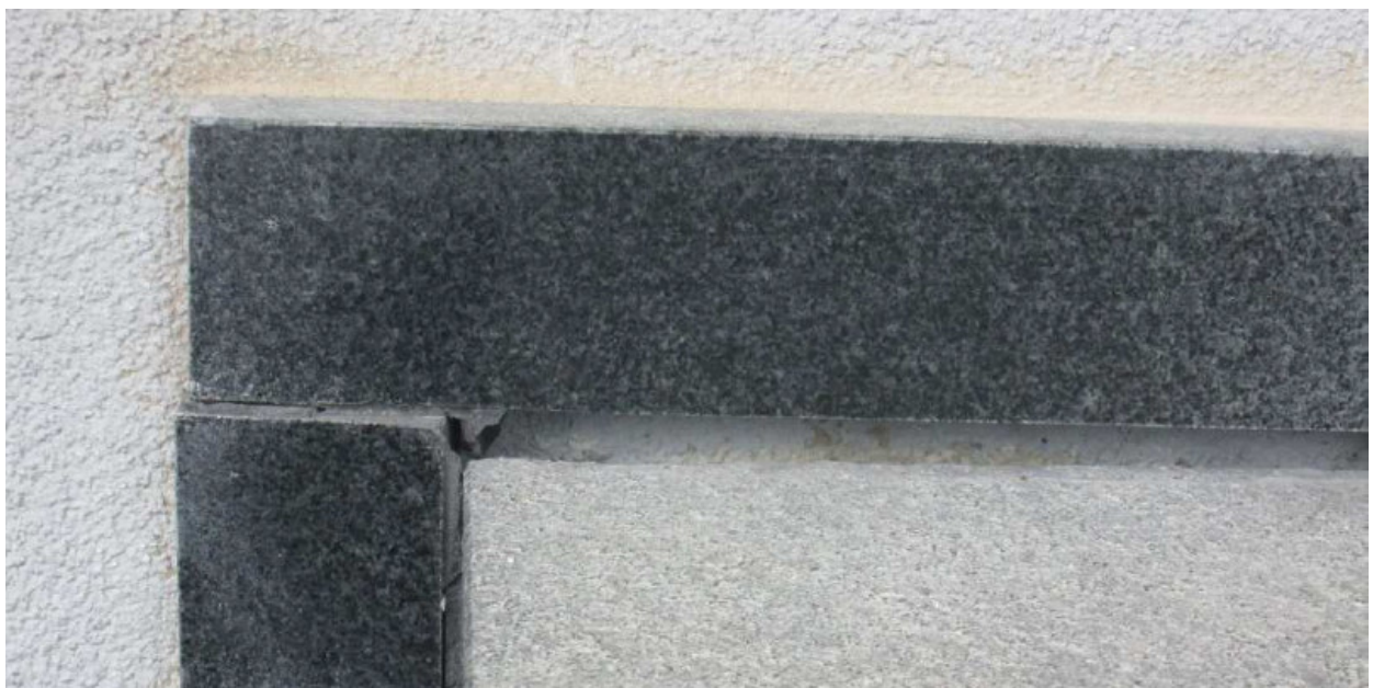
Bild 12: Ablösungen zwischen Eingang und Fassade
