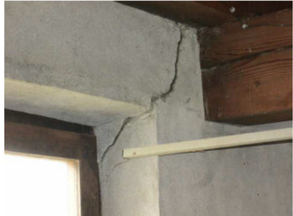
Bild 19: Riss in talseitiger Außenwand
