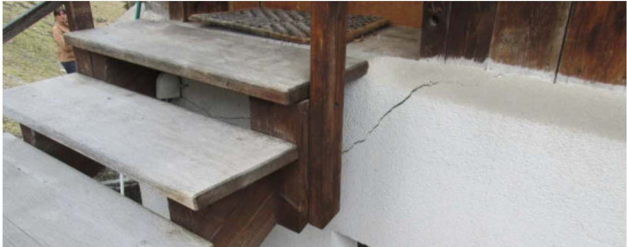
Bild 24: Riss beim Auflager des Treppenzuganges
