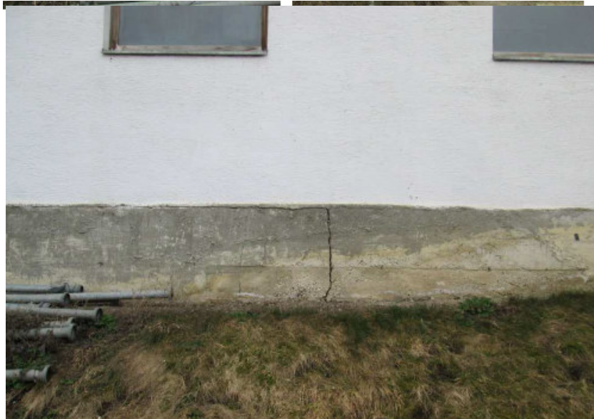
Bild 46: Riss in Fundierungs-Mauer
