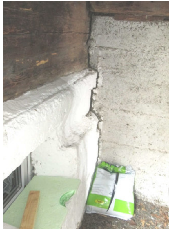
Bild 33: Wandsetzungsrisse auch mit wandnormalem Versatz
